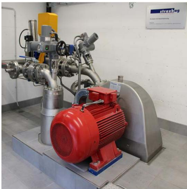
Maschinengruppe mit Turbinenbypass (links)
