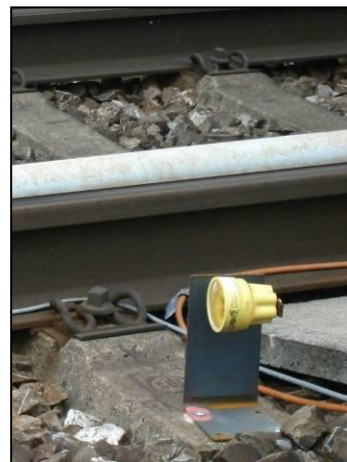
Überwachungspunkt (Reflektor) auf Bahnschwelle
